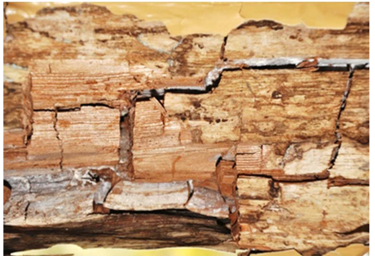
Brown cubical rot
